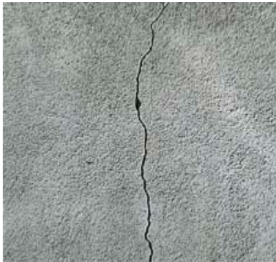
Bild: Dieses Bild vom Gemeindehaus der Martin-Luther-Kirche ist symptomatisch. Es zeigt Risse, die an manchen Stellen bis zu 8 Meter lang sind. Bei genauer Betrachtung existieren Risse an allen Seiten des Gebäudes!
